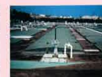
水処理施設 防臭蓋 Tank Cover
