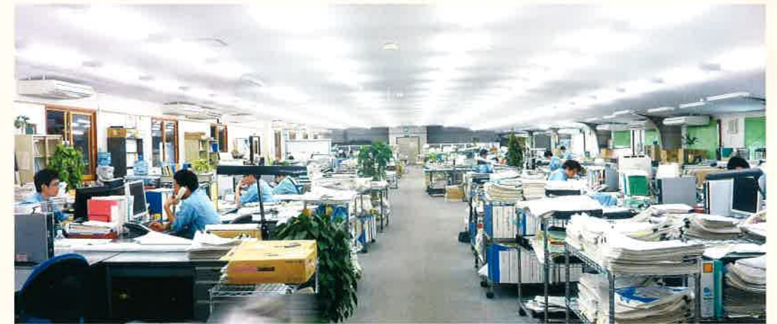
●設計室(約750㎡~多くの社員が勤務する広い空間) 地中熱システム用に3.2馬力相当の室内機が16台設置されている。室内温度・エアコンの吹き出し口の温度などを常時計測・記録している。
