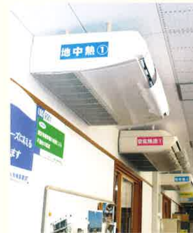
●室内機 設計室内に併設された地中熱と空気熱の空調機。
