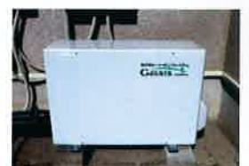
地中熱利用ヒートポンプ
