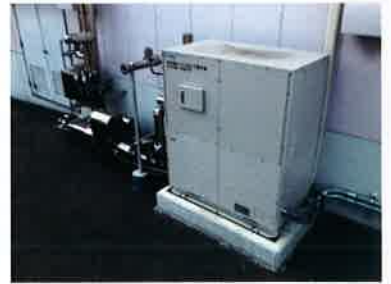
地中熱利用ヒートポンプ（室外機）
